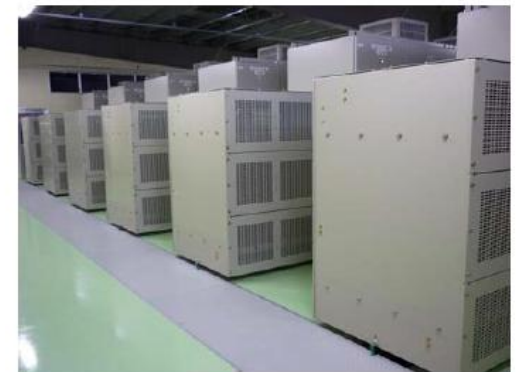
4.5MVA 交直変換装置
